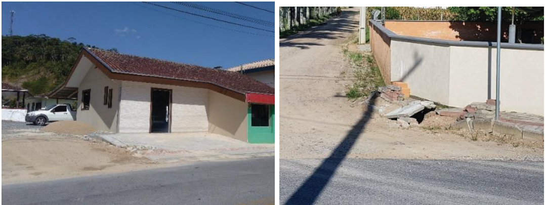
FOTO 01 E 02: INFRAESTRUTURA DANIFICADA
