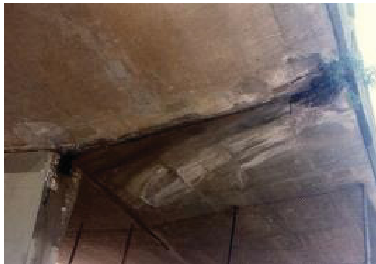
FIGURA 2-14 – MANIFESTAÇÃO DE PATOLOGIA EM JUNTAS - EXEMPLO 1
