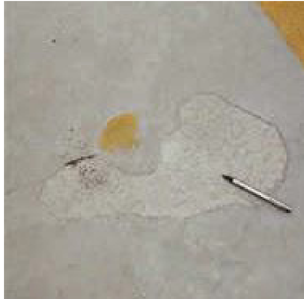
FIGURA 2-12 – DELAMINAÇÃO EM PISO DE CONCRETO
