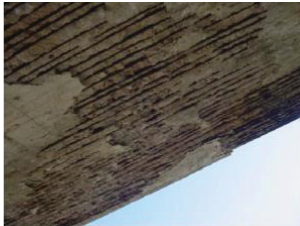
FIGURA 2-7 – CORROSÃO POR CARBONATAÇÃO
