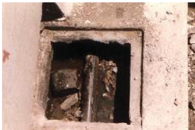
FIGURA 2-16 – OBSTRUÇÃO DA GALERIA PLUVIAL, VIADUTO TIRADENTES
