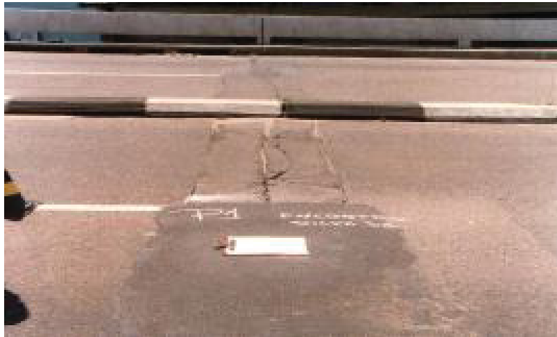
FIGURA 2-15 – MANIFESTAÇÃO DE PATOLOGIA EM JUNTAS - EXEMPLO 2
