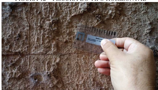
FIGURA 12 – FISSURA DO TIPO HORIZONTAL
