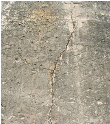
FIGURA 11 – FISSURA DO TIPO VERTICAL
