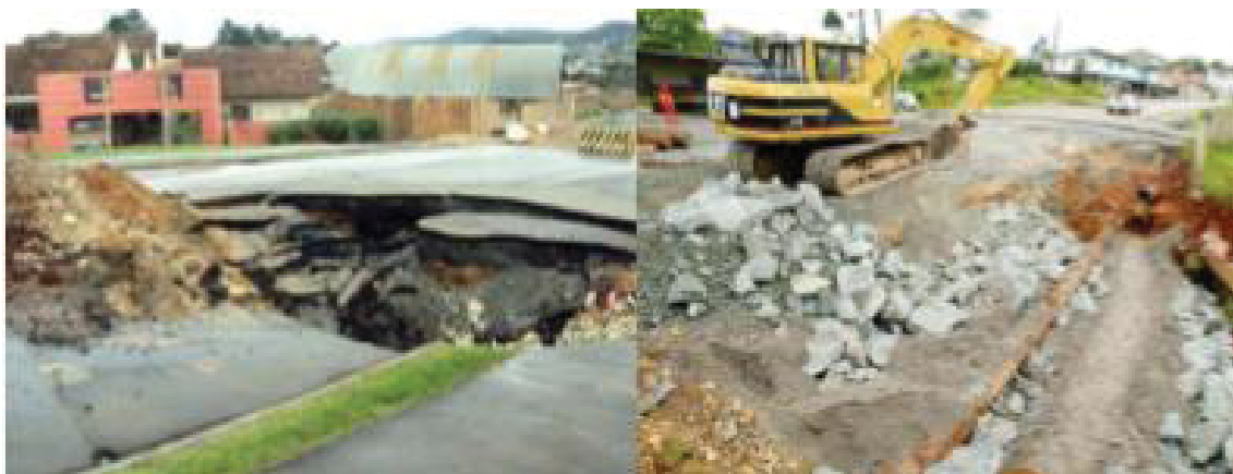
FIGURA 8: AFUNDAMENTO PROGRESSIVO OCORRIDO EM DEZEMBRO NA RUA DOMINGOS SCUCATO EM FRENTE À ESCOLA JACI REAL PRADO DE OLIVEIRA. MARCO INICIAL DA TRAJETÓRIA DAS INTERDIÇÕES OCORRIDAS EM 30 DE MARÇO DE 2011
