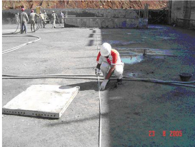
FIGURA 48 - LOCAÇÃO COM TRENA DE LOCAL A SER LANÇADO O CABO TFOR E CRAVAÇÃO DE PREGOS GUIAS
