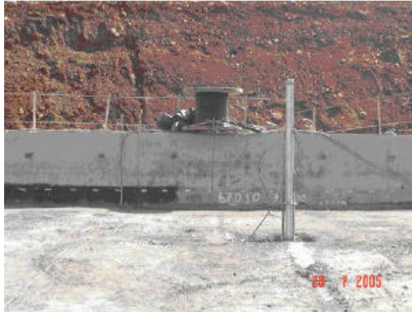
FIGURA 57 - REPOSIÇÃO DA BOBINA DE CABOS TFOR SOBRE A FÔRMA DA FACE DE MONTANTE
