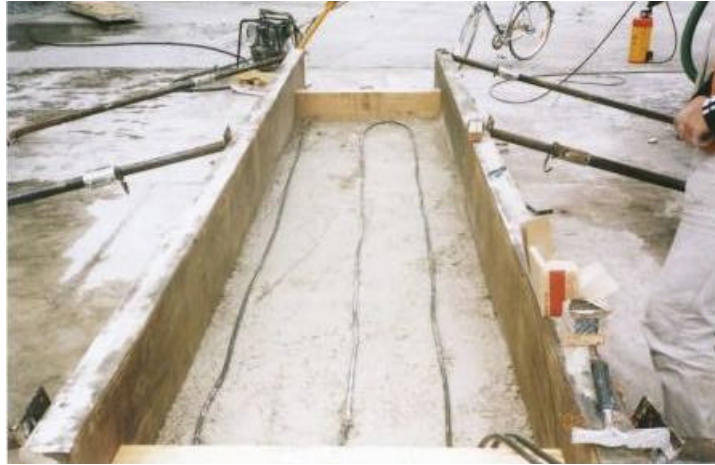
FIGURA 29 - DETALHE DA COLOCAÇÃO DOS CABOS NA CAMADA SUPERIOR, BLOCO DE TESTES TFOR
