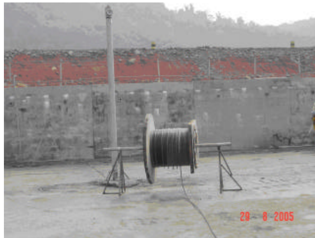
FIGURA 52 - RETIRADA DA BOBINA DE CABOS TFOR QUE ESTAVA SOBRE A FÔRMA DA FACE DE MONTANTE
