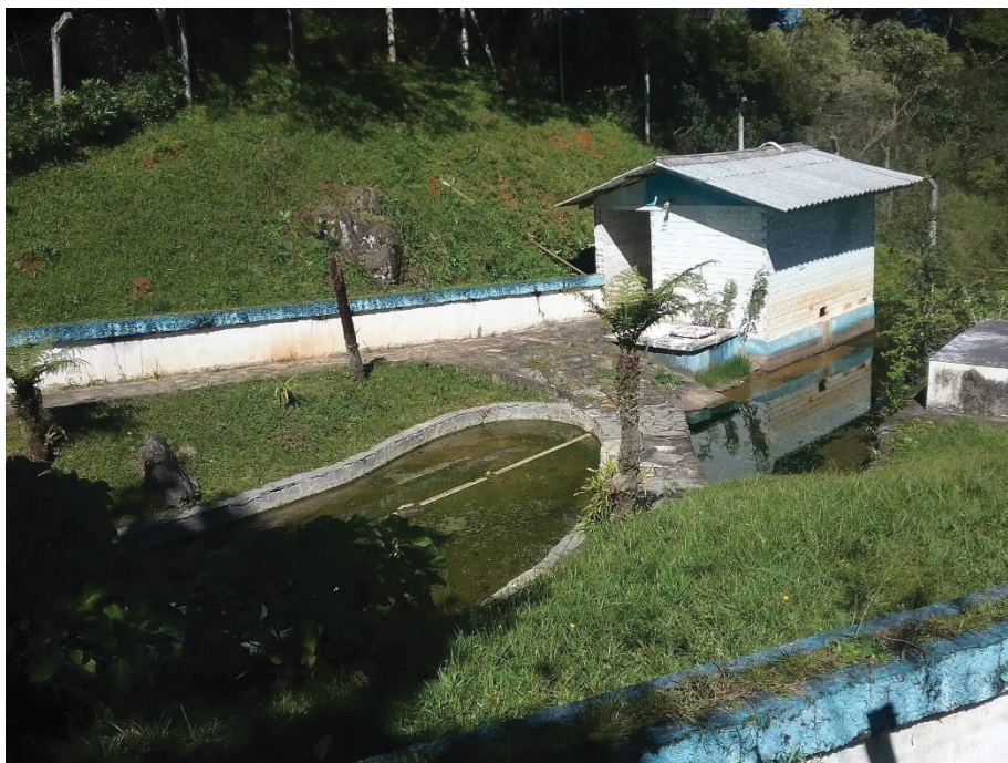
FIGURA 19 - ÁREA DE ENTORNO DO POÇO SAN/931
