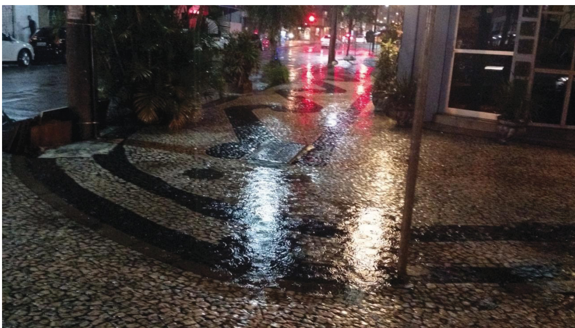
Figura 11 Acúmulo de água em calçadas com superfície irregular. Crédito: do autor.
