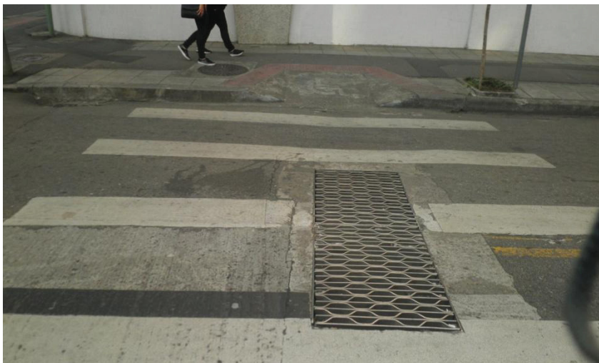
Figura 35. Cruzamento com obstáculo (grade de caixa de transformadores) na rota de travessia de pessoas em cadeira de rodas, na esquina da Rua André de Barros com Rua Lourenço Pinto (nota 0,5).
