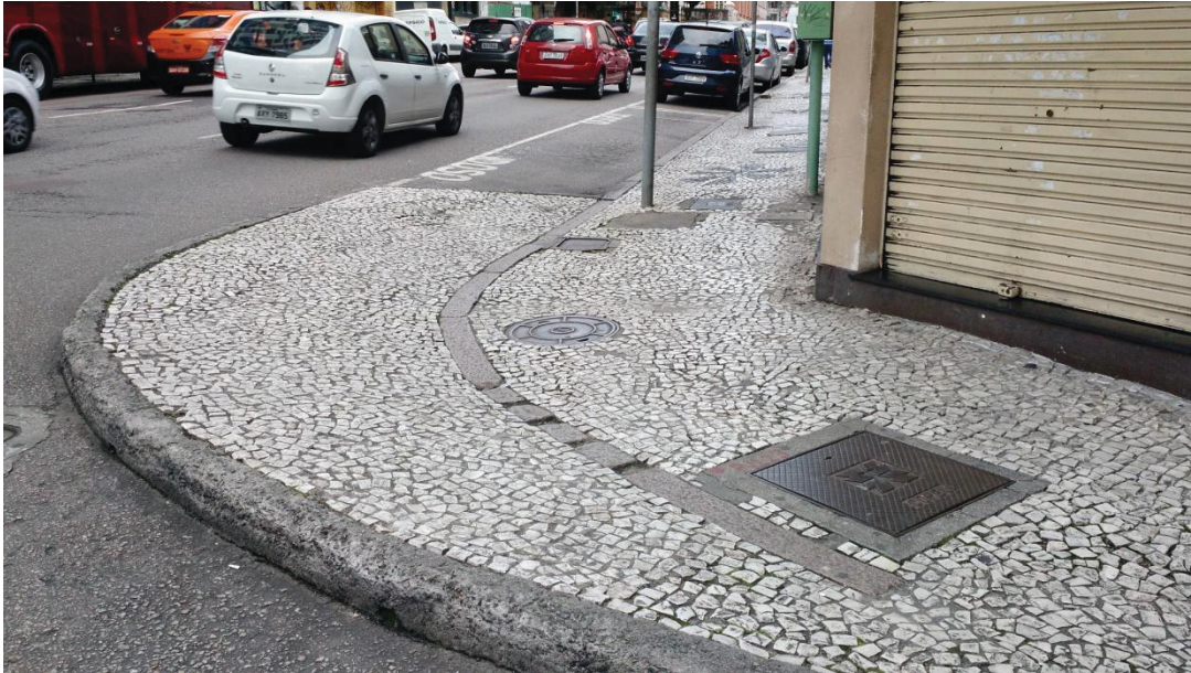
Figura 4 Avanço de calçada na Rua Cruz Machado. Crédito: do autor.
