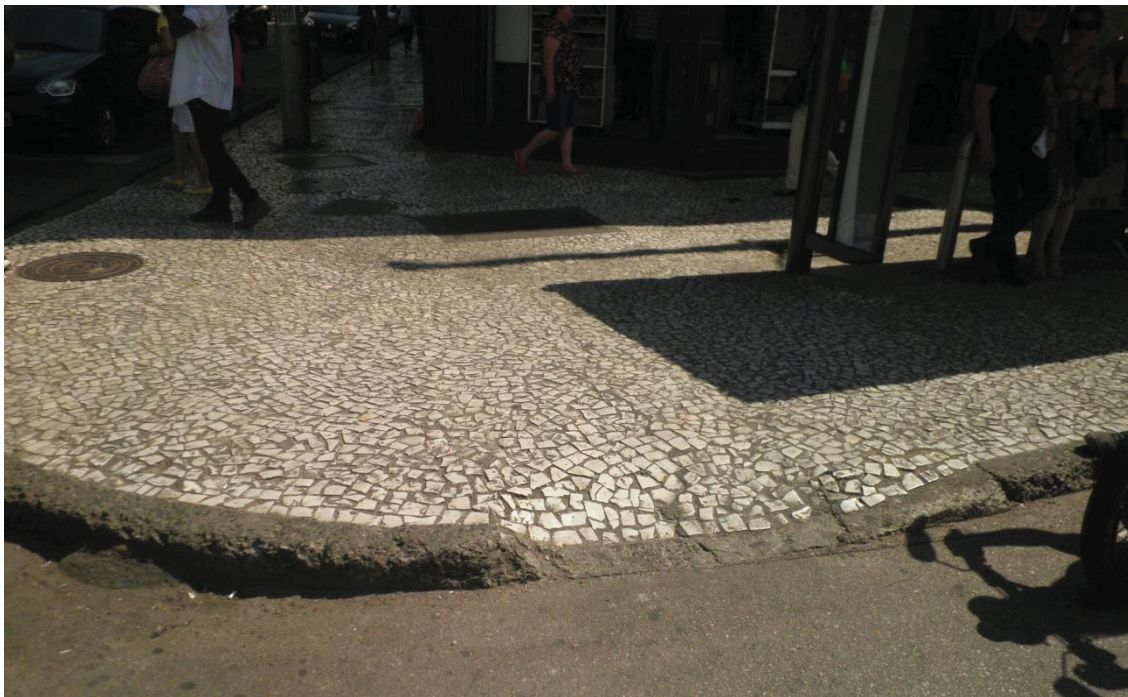
Figura 14 Meio-fio rebaixado que não atende às normas de acessibilidade quanto à segurança e autonomia de pessoas em cadeiras de rodas.
