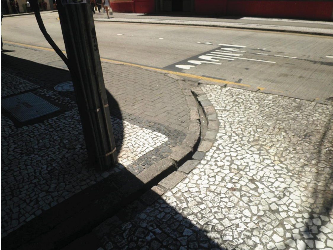
Figura 23 Canaleta de drenagem cruzando a faixa de circulação da calçada na Praça Carlos Gomes, esquina da Rua Pedro Ivo com a Rua Monsenhor Celso.
