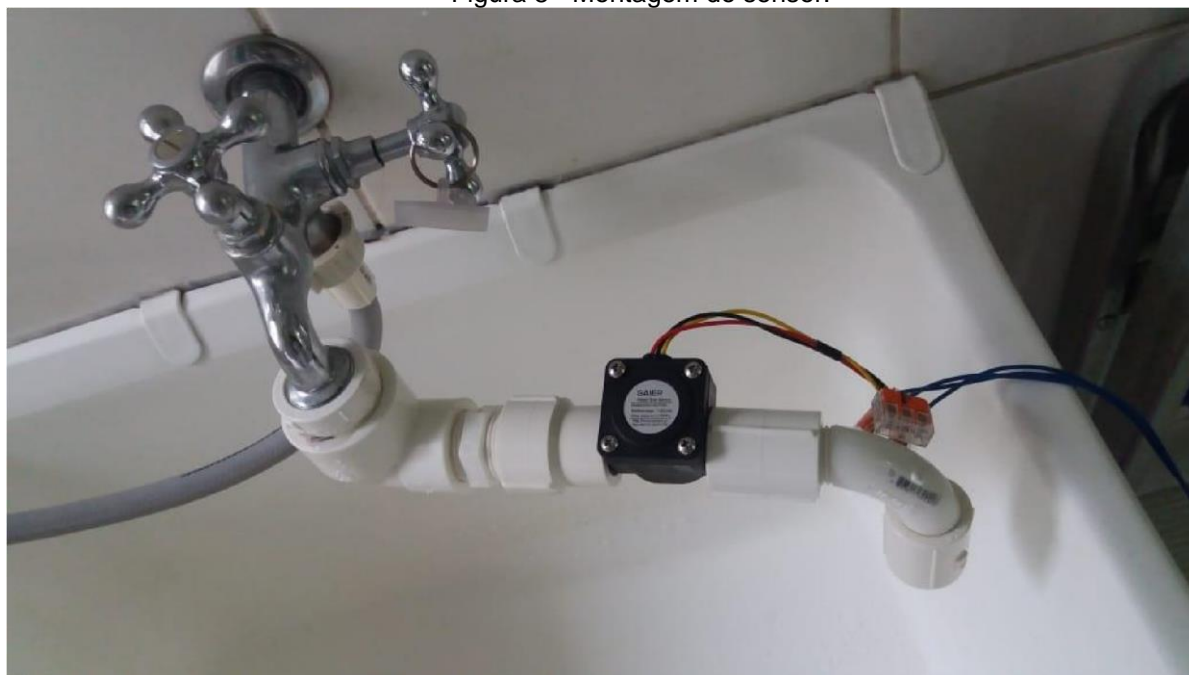
Figura 8 – Montagem do sensor. (Fonte: AUTORES DO PROJETO) 2018.
