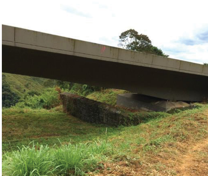
FIGURA 30 - GABIÃO INCLINADO PRÓXIMO AO PÉ DO TALUDE NO KM 552+000 PN
