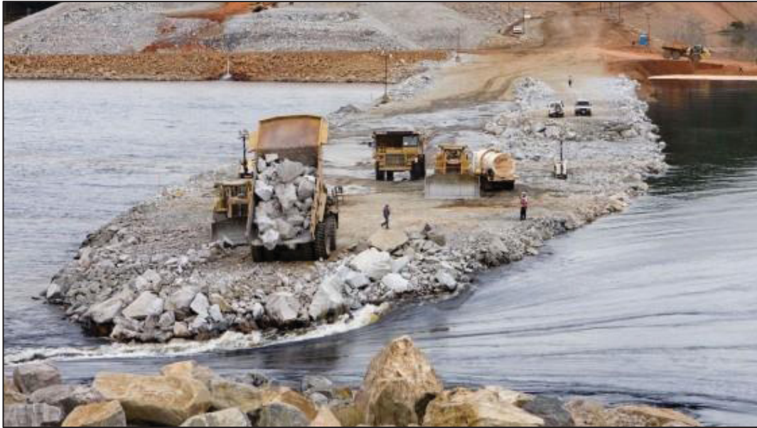
FIGURA 2.16 - FECHAMENTO DA BRECHA DO RIO CARONÍ, USINA HIDRELÉTRICA MANUEL CARLOS PILAS (TOCOMA) FONTE: SOMBRA (2011)
