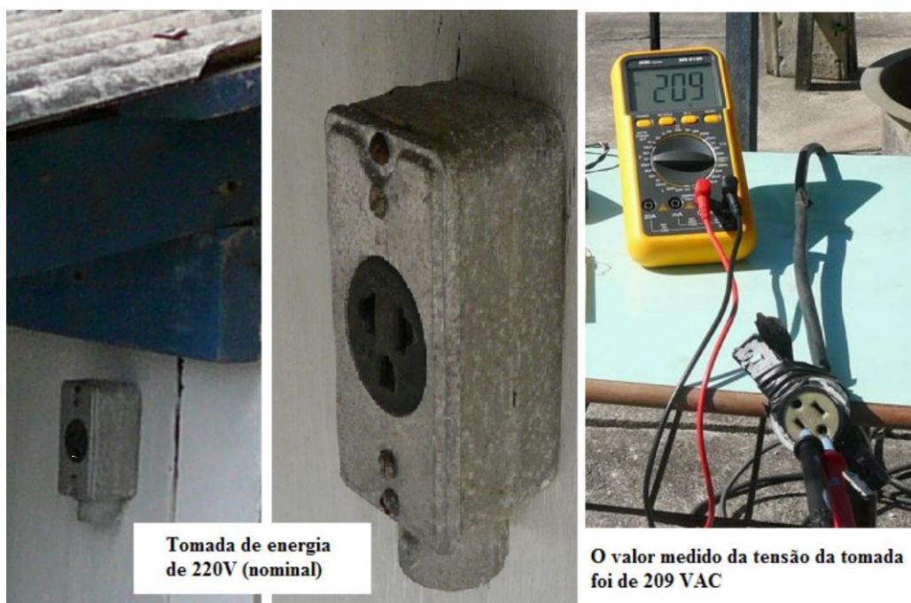
Figura 32 - Tomada de energia de 220V nominal localizada próximo ao mangue e utilizada para fazer o teste. A tensão medida foi de 209 VAC.
