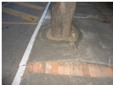
FIGURA -26 PASSEIO DANIFICADO E AUSÊNCIA DE ÁREA DE CRESCIMENTO.
