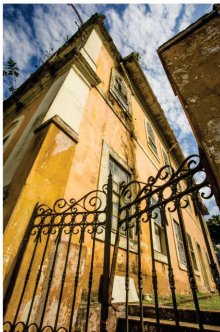
Muitas infiltrações são vistas tanto no exterior quanto no interior do palacete. Foto: Hugo Harada/Gazeta do Povo
