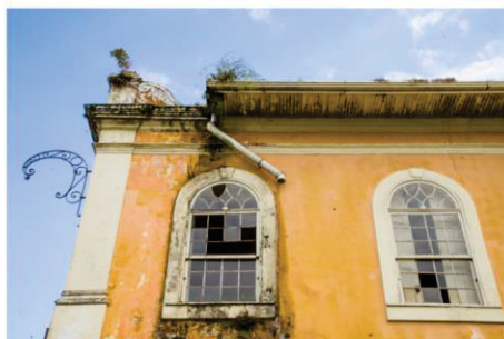
Enquanto a Secretaria de Cultura diz que a obra pode ser feita em um ano, o arquiteto Key Imaguire avalia que os danos são muito extensos para um prazo tão curto. Foto: Hugo Harada/Gazeta do Povo
