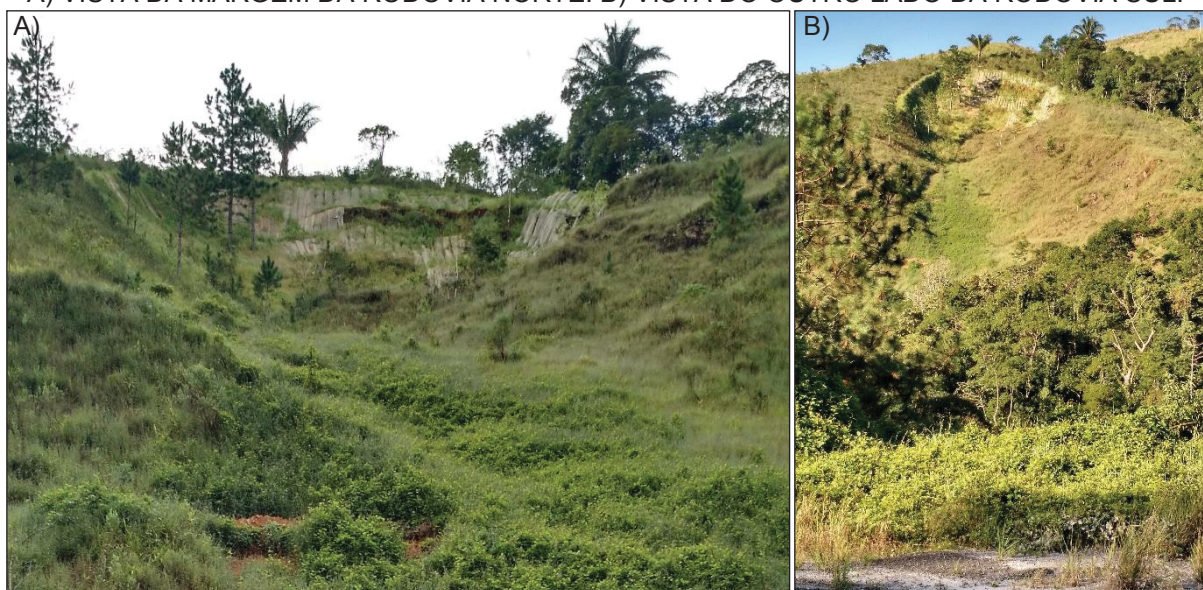
FIGURA 23 - CICATRIZ DE ESCORREGAMENTO TRANSLACIONAL EM SOLO NO KM 518+500. A) VISTA DA MARGEM DA RODOVIA NORTE. B) VISTA DO OUTRO LADO DA RODOVIA SUL.
