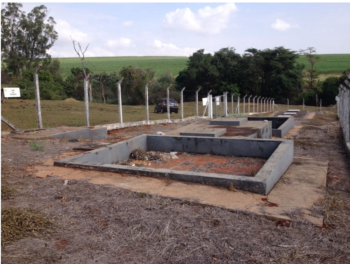
Figura 16 - Local das instalações da ETE do distrito
