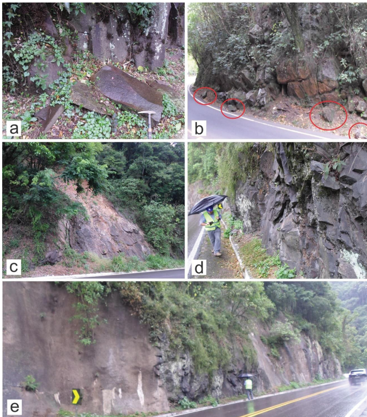
Figura 6.17 Diversos problemas geotécnicos evidenciados ao longo da BR-116. a) Detalhe de blocos caídos, ponto 2. b) Blocos tombados em talude com inclinação negativa, ponto 3. c) Cicatriz antiga de deslizamento planar, ponto 5. d) Talude que apresenta grande diversidade de famílias de fratura e alto risco de deslizamentos, ponto 6. e) Visão geral do ponto 6, com grande extensão de taludes concretados, numa tentativa de estabilizar a vertente.
