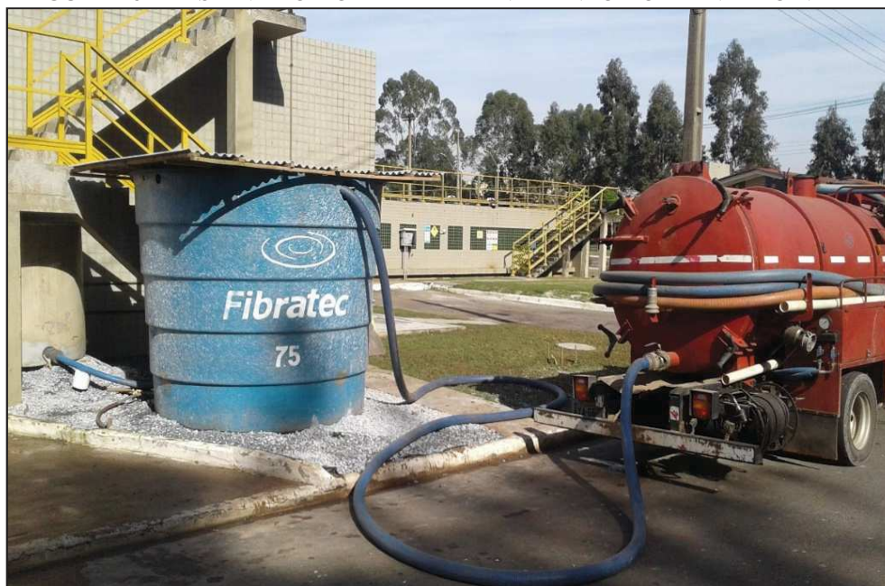
FIGURA 16 – RESERVATÓRIO DE ARMAZENAMENTO DO LIXIVIADO NA ETE
