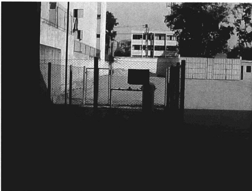
Vista da central de gás em tanque subterrâneo.
