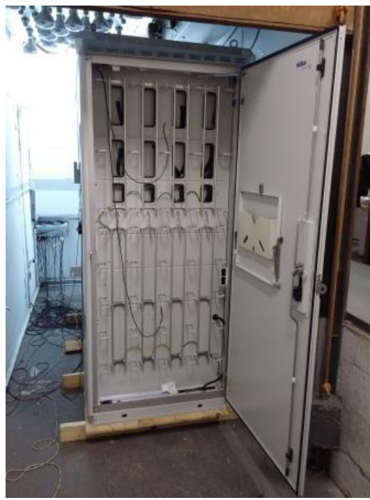
Figura 3: Vista interna DG direita
