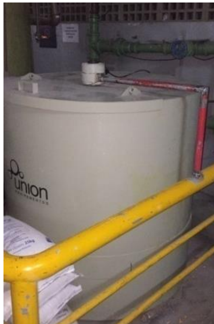
Figura 37 – Tanque de Salmoura
