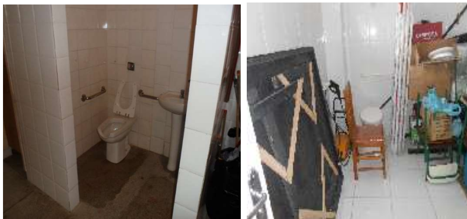
Figura 4. Falta de adaptação dos banheiros
