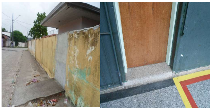
Figura 3. Fotos da falta de acessibilidade e de condições inadequadas de acessibilidade.
