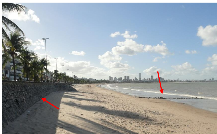
Figura 17. Muro de arrimo e resquícios de gabiões na praia de Manaíra, João Pessoa - PB
