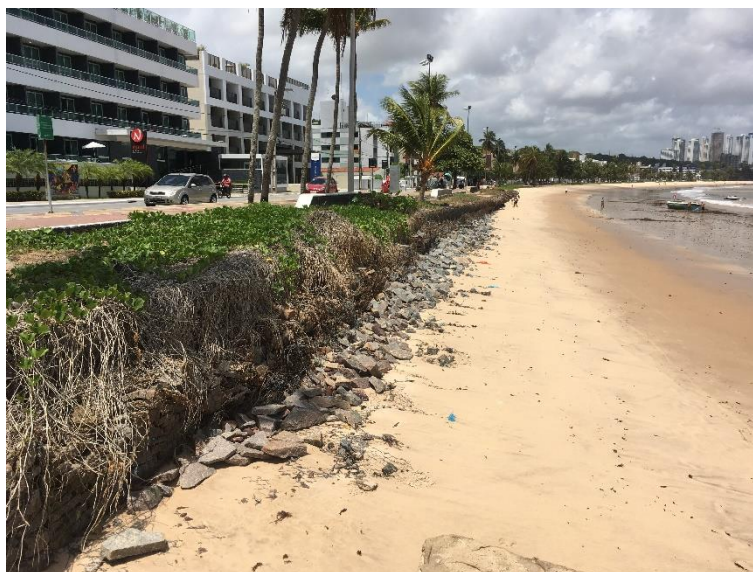
Figura 24. Muro de gabião no início da Área 1 da praia do Cabo Branco, João Pessoa – PB
