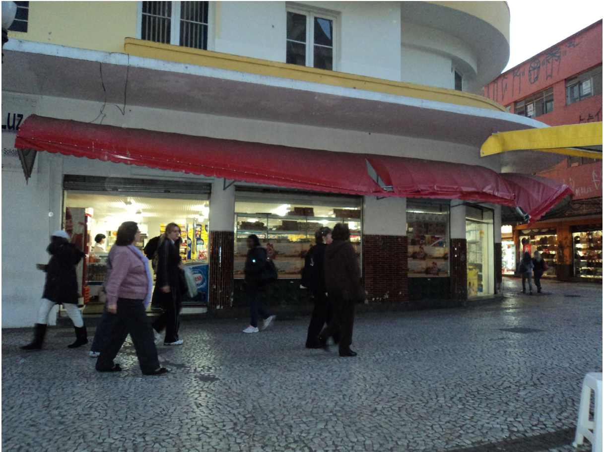
FIGURA 7 - TOLDOS MAL CONSERVADOS PREJUDICANDO A COMPOSIÇÃO DA FACHADA FONTE: A autora (2011)
