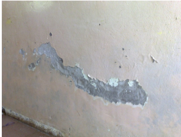
Figura 23 – Pátio coberto, com infiltração pela umidade do solo que sobe pela parede por falta de impermeabilização do baldrame, posterior descascamento da pintura.
