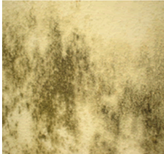
Figura 12 – Mofo, exemplo de defeito na pintura
