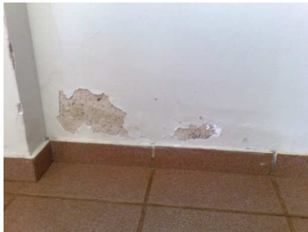
Figura 24 – Pátio coberto, com infiltração pela umidade do solo que sobe pela parede por falta de impermeabilização do baldrame, posterior descascamento da pintura.
