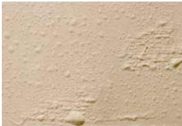
Figura 7 – Bolhas em paredes externas, exemplo de defeito na pintura
