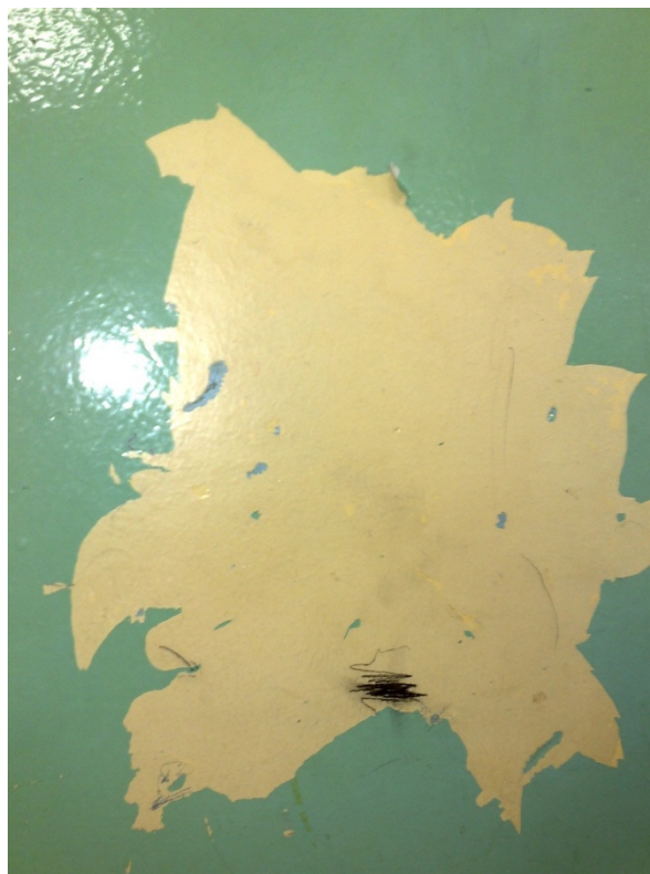
Figura 20 – Sala de aula com descascamento da pintura
