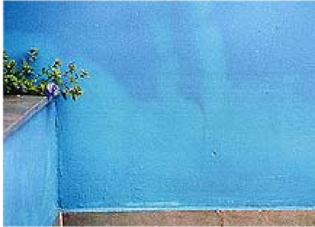
Figura 1 – Eflorescência, exemplo de defeito na pintura
