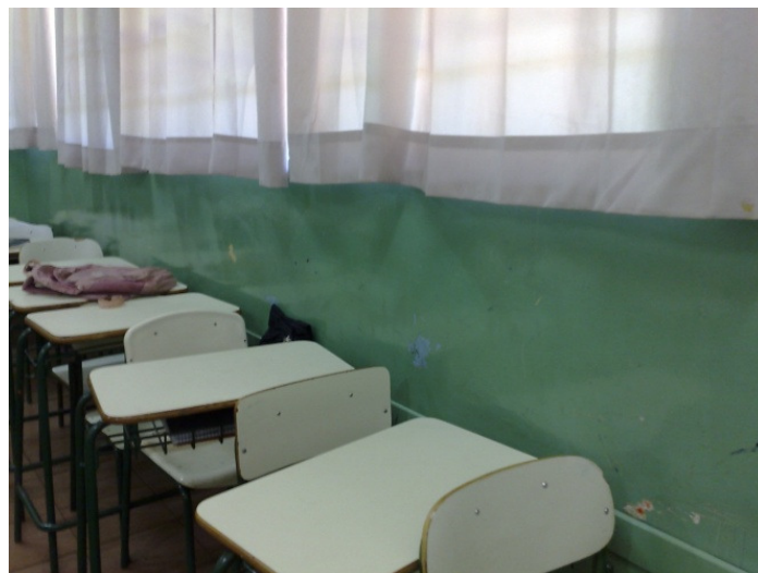
Figura 18 – Sala de aula com descascamento da pintura
