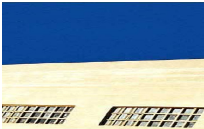
Figura 4 - Manchas causadas por pingos de chuva, exemplo de defeito na pintura
