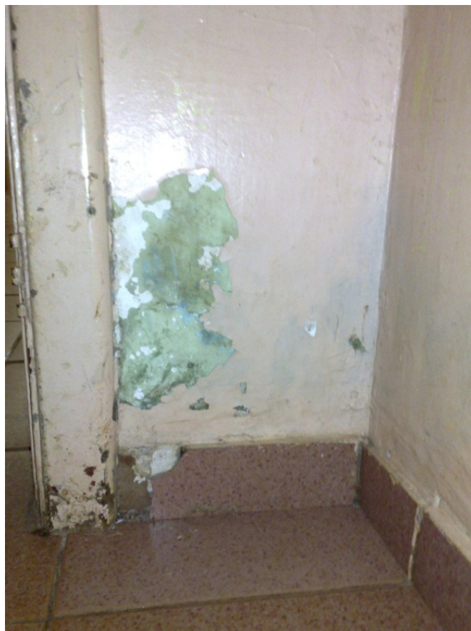
Figura 22 – Área de circulação, próximo ao rodapé, com infiltração pela umidade do solo que sobe pela parede por falta de impermeabilização do baldrame, posterior descascamento da pintura.
