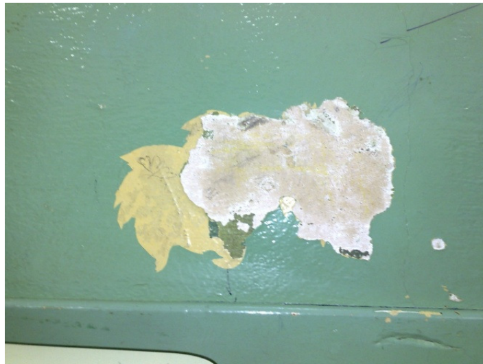
Figura 17 – Sala de aula com descascamento da pintura
