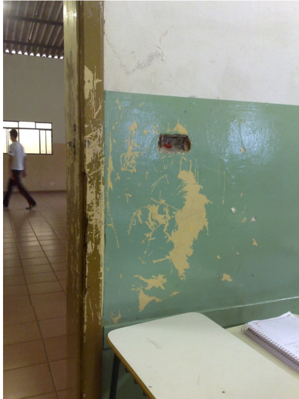
Figura 19 – Circulação interna com descascamento da pintura
