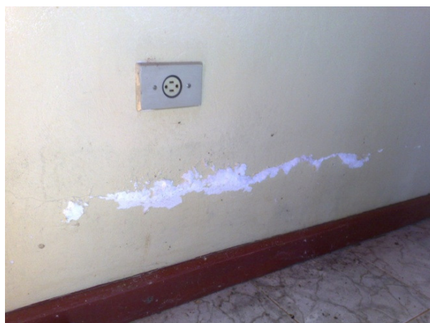
Figura 25 – Laboratório de Biologia, com infiltração pela umidade do solo que sobe pela parede por falta de impermeabilização do baldrame, posterior descascamento da pintura e apodrecimento do reboco.
