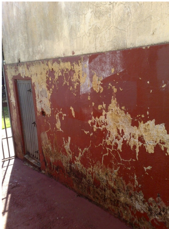
Figura 27 - Áreas externas sujeitas a sol forte, chuvas e variações bruscas de temperaturas.
