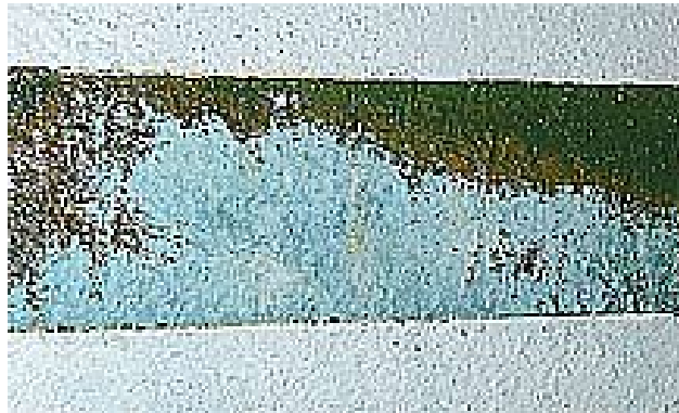
Figura 3 – Saponificação, exemplo de defeito na pintura
