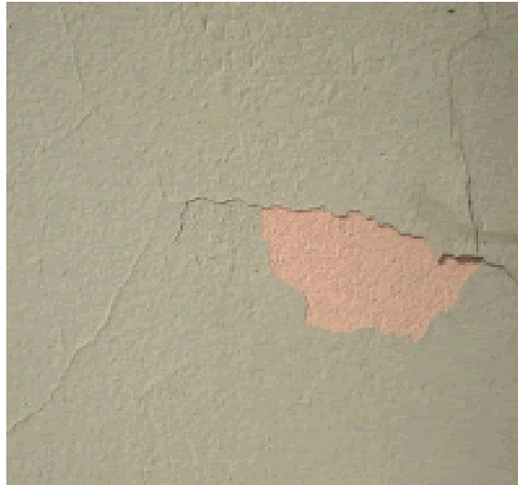
Figura 6 - Descascamento, exemplo de defeito na pintura
