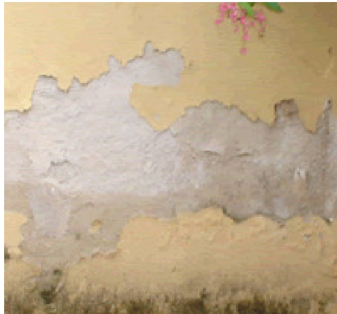
Figura 2 – Desagregamento, exemplo de defeito na pintura
