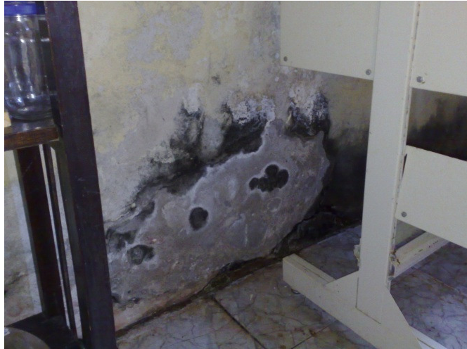
Figura 26 – Laboratório de Biologia, com infiltração de umidade com a instalação de colônias de microorganismos (mofo, bolor, fungo ou alga). Como um câncer, a colônia vai penetrando na pintura e depois da alvenaria.
