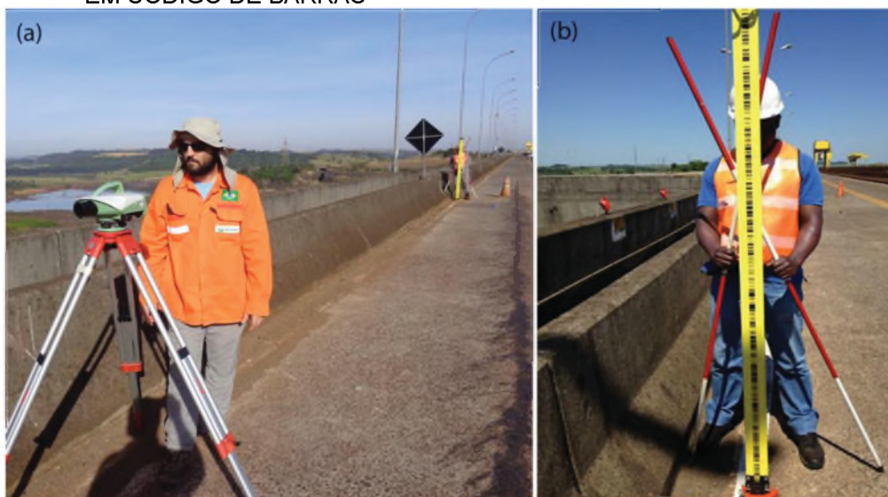
FIGURA 59 - (A) NIVELAMENTO GEOMÉTRICO NA CRISTA DA BARRAGEM DA UHGJR UTILIZANDO O NÍVEL DIGITAL LEICA DNA03 (B) MIRA DE ÍNVAR LEICA GRAVADA EM CÓDIGO DE BARRAS
