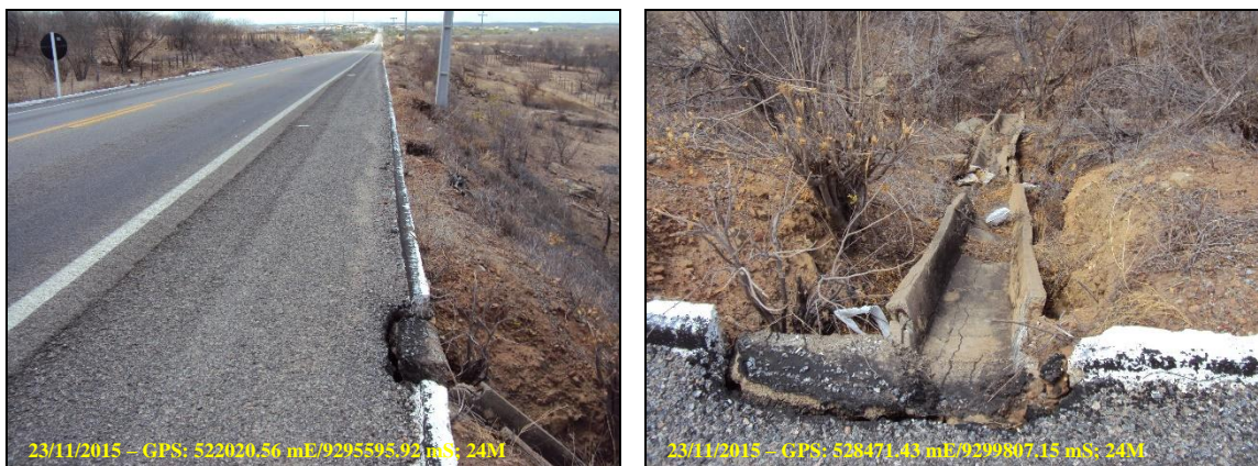
FIGURA 13 – DRENAGEM DANIFICADA EM TALUDE DE ATERRO.
