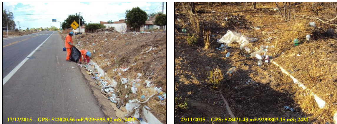
FIGURA 7 – ATIVIDADE DE RECOLHIMENTO DOS RESÍDUOS SÓLIDOS DOMÉSTICOS DISPERSOS NA FAIXA DE DOMÍNIO DA RODOVIA, INCLUINDO MANUTENÇÃO NOS DISPOSITIVOS DE DRENAGEM.
