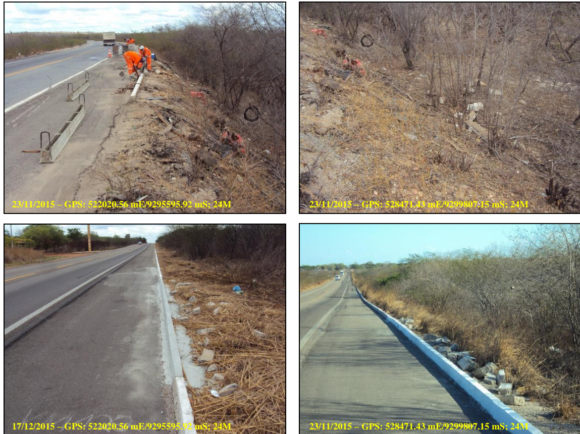
FIGURA 3 – ATIVIDADE DE CONCRETAGEM DE MEIO FIO E DEPÓSITO DOS RESÍDUOS SÓLIDOS (CALIÇA) DECORRENTES DESTA ATIVIDADE.
