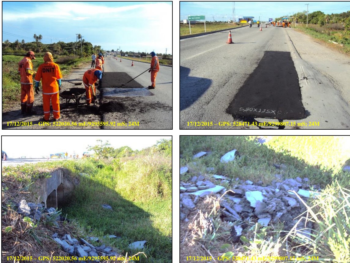
FIGURA 6 – ATIVIDADE DE RECAPEAMENTO COM CBUQ E RESÍDUOS SÓLIDOS DESCARTADOS. EM ÁREA DE PRESERVAÇÃO PERMANENTE (APP).
