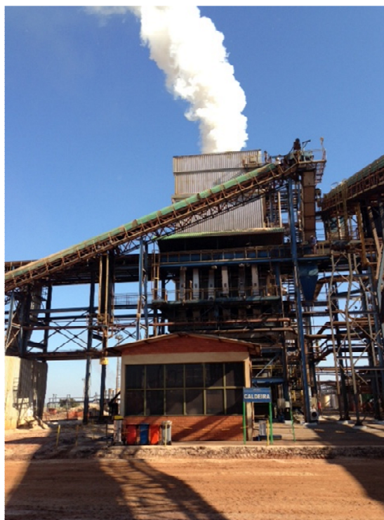
Figura 2 - Foto Caldeira Usina Moema Fonte: Área Industrial da Usina Moema Açúcar e Álcool Ltda.
