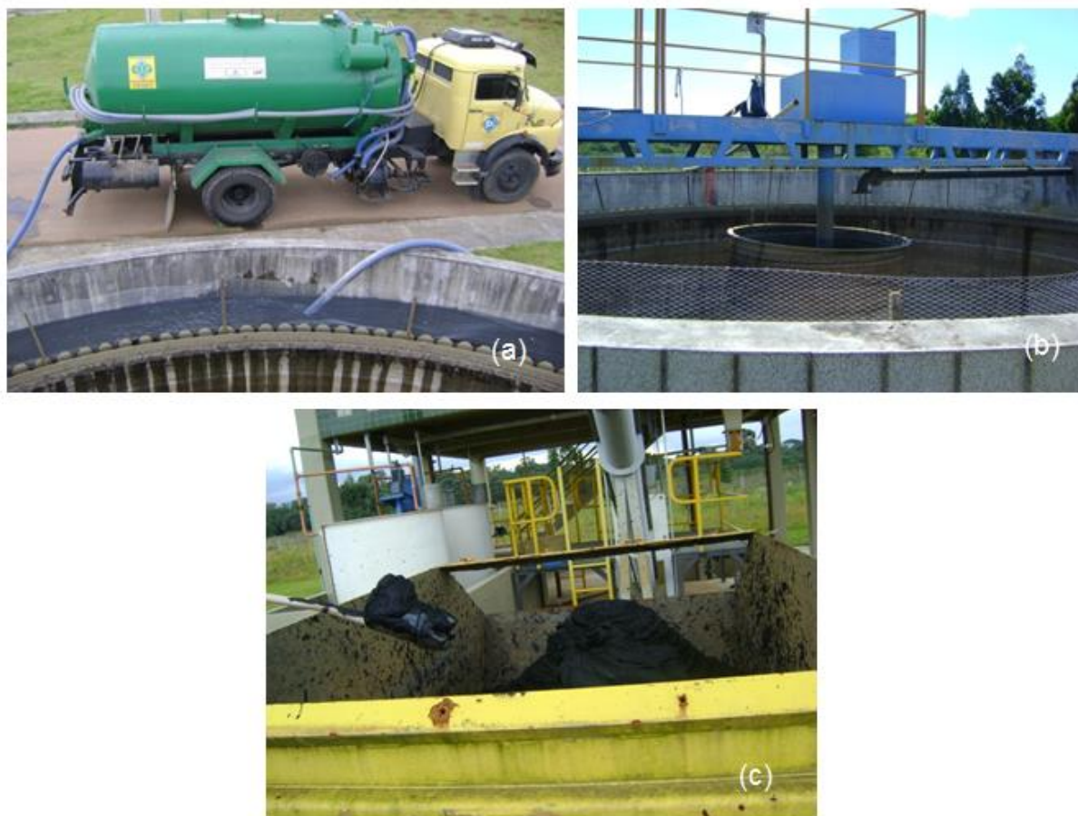
FIGURA 3.4 – OBTENÇÃO DO LODO DE FOSSA SÉPTICA: A) DESCARREGAMENTO DO LODO NA ETE POR CAMINHÃO LIMPA-FOSSA; (B) ADENSADOR POR GRAVIDADE COM TELA; C) TORTA DO LODO CENTRIFUGADO
