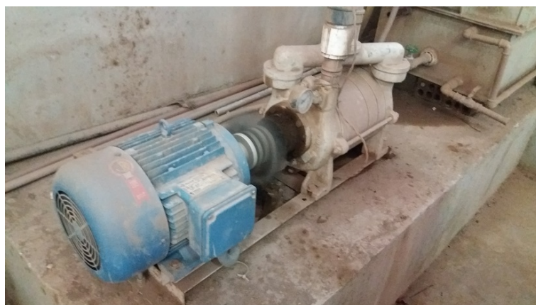
Figura 16 – BOMBA DE VÁCUO ACOPLADA À EXTRUSORA
