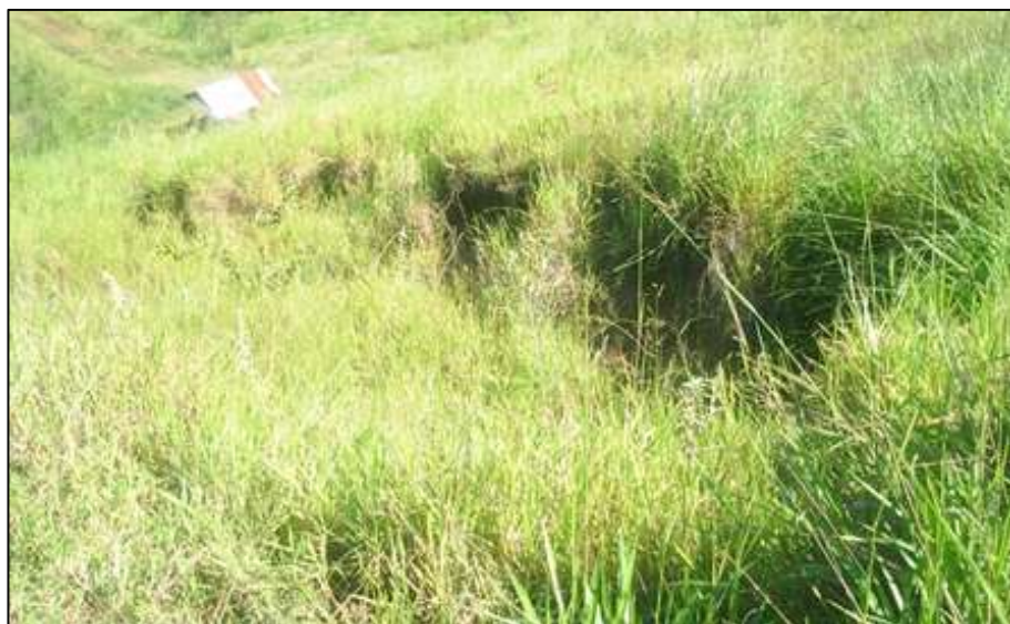
Fotografia 8: Processo erosivo – Sítio Nossa Senhora Aparecida
