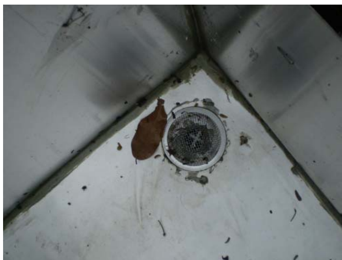
Figura 34: Detalhe da proteção da válvula do espaço 2 que simula uma laje. Fonte: A autora (2011).
