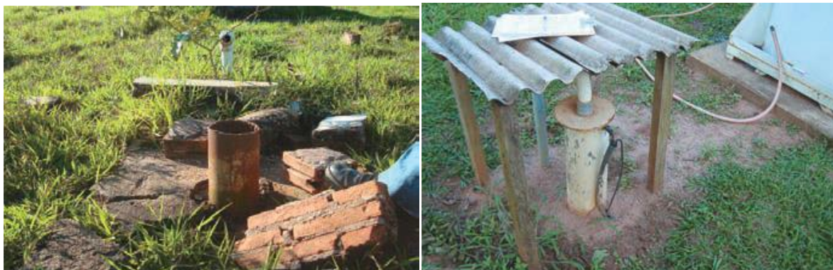
FIGURA 5 - POÇOS TUBULARES PROFUNDOS ABANDONADOS E CONSTRUÍDOS SEM CRITÉRIOS TÉCNICOS
