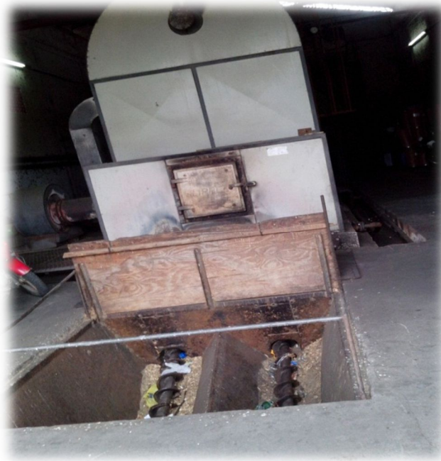
FIGURA 4 – Caldeira para queima de resíduos gerando vapor para as estufas. FONTE: autoria própria.
