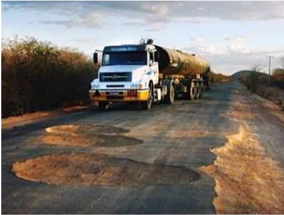
FIGURA 7 – Tráfego em rodovias em más condições
