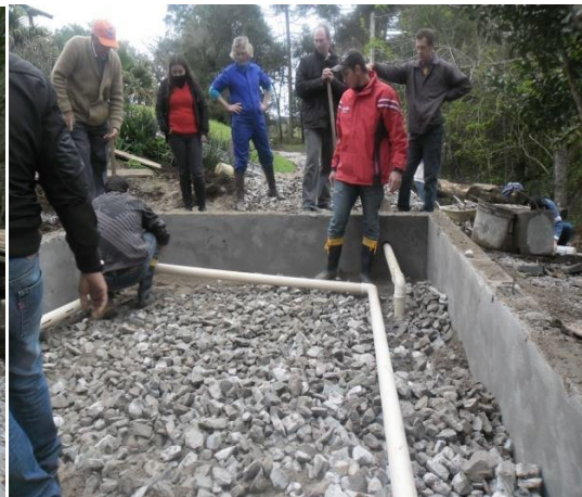
Figura 05 B. Pedras e tubulação.
