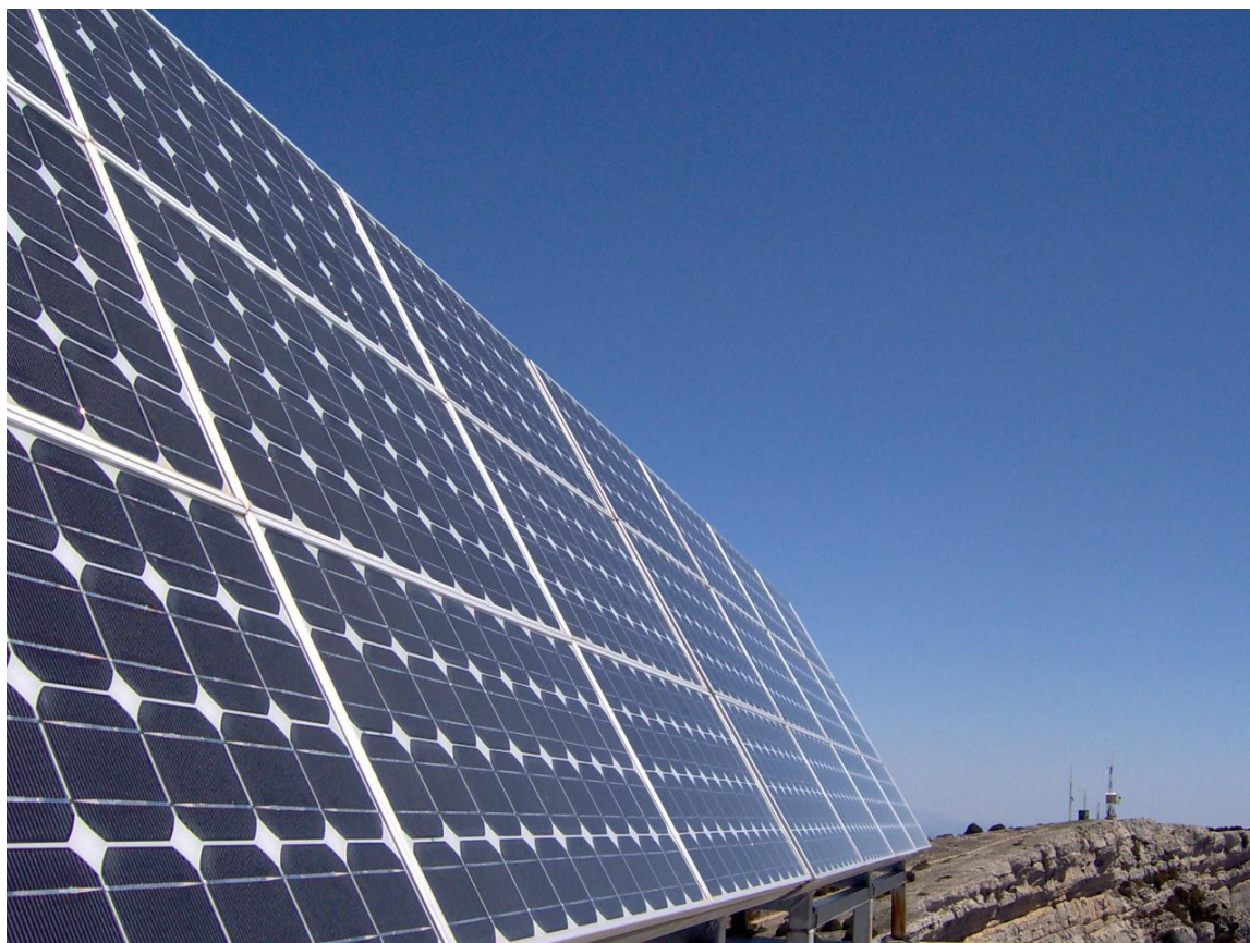
IMAGEM 04: Placas de Energia Solar
