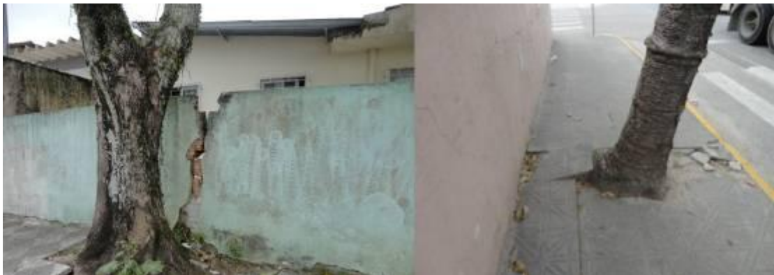
Figura 5: Danos causados pela arborização à muros e calçadas (São João).
