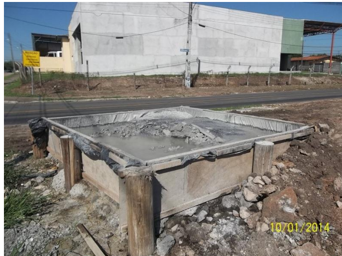
FIGURA 3 – Caixa de sedimentação de resíduos de concreto para a limpeza caminhões concreiteiros.
