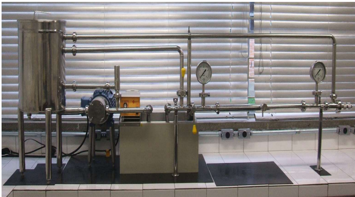
FIGURA 18 – UNIDADE EXPERIMENTAL DE MICROFILTRAÇÃO (EMULTEC-UFPR)
