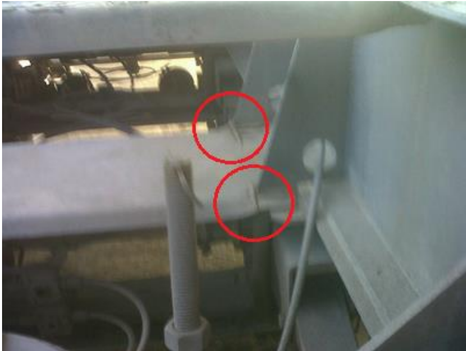
Figura 4 – Trincas típicas no suporte central – chapa superior.
