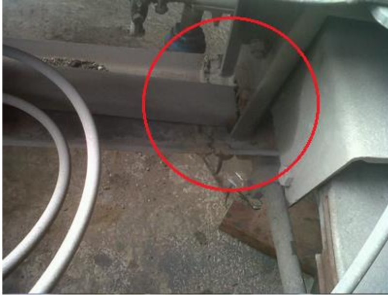
Figura 6 – Trincas típicas no suporte central – chapa inferior e travessa.
