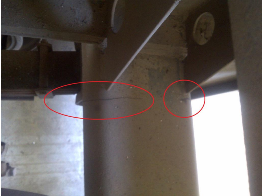
Figura 2 – Trincas típicas no suporte traseiro – chapa superior.
