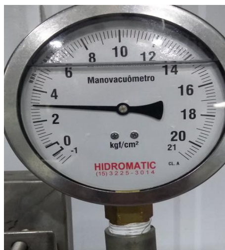
FIGURA 2 – MANOVACUÔMETRO DEMONSTRANDO A PRESSÃO DA REDE DE ÁGUA UTILIZADA NO CHUVEIRO DE LAVAGEM.
