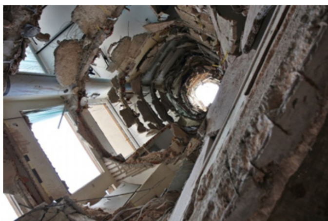
FIGURA 3 – Desabamento parcial de laje no edifício Senador, em São Bernardo do Campo, na Grande São Paulo (ocorrido em 2012).
