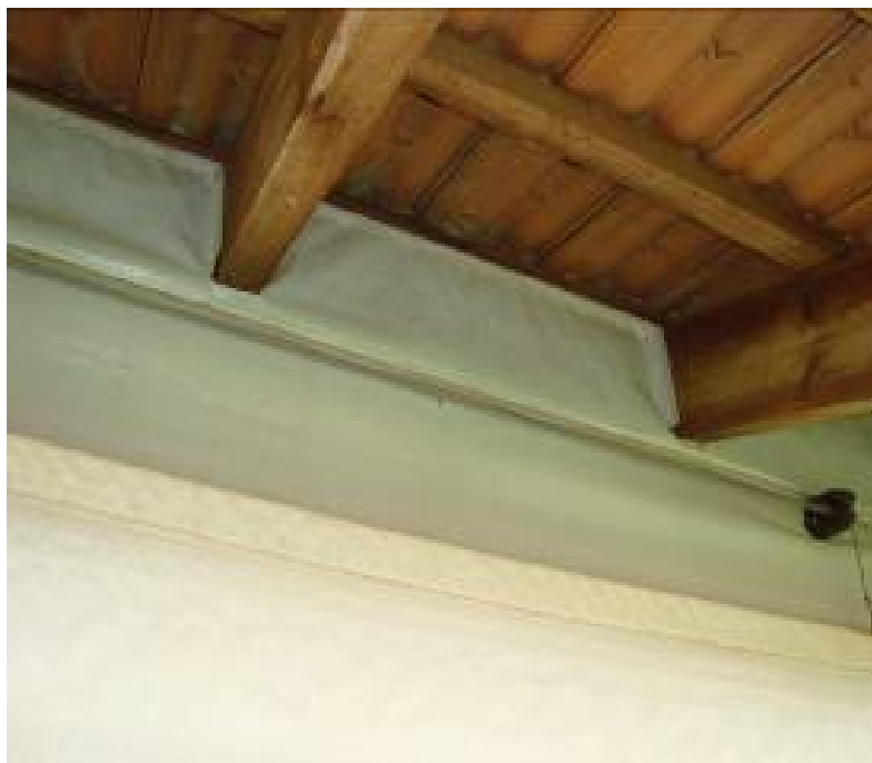
FIGURA 6 - Vedação adequada do forro.
