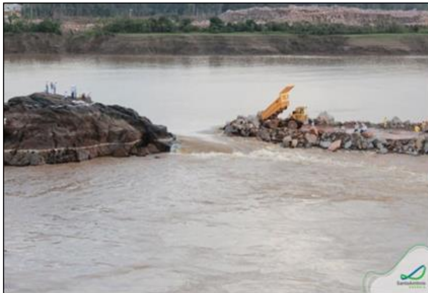
FIGURA 2.13 - FECHAMENTO DO CORDÃO DE ENROCAMENTO DO LEITO DO RIO MADEIRA PARA A CONSTRUÇÃO DA UHE SANTO ANTÔNIO (PORTO VELHO – RONDÔNIA) FONTE: SANTO ANTONIO ENERGIA, 2014
