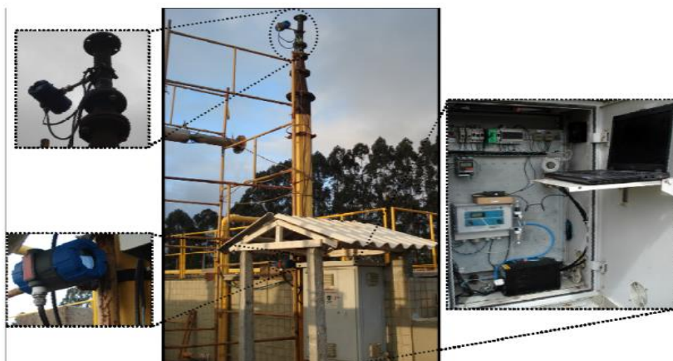
FIGURA 7 - FOTO DO ARRANJO EXPERIMENTAL PARA MEDIR EM TEMPO REAL OS SEGUINTE PARÂMETROS INERENTES AO BIOGÁS: (a) VAZÃO, (b) TEOR DE METANO, c) TEMPERATURA, (d) PRESSÃO MANOMÉTRICA FONTE: SANEPAR (2011)
