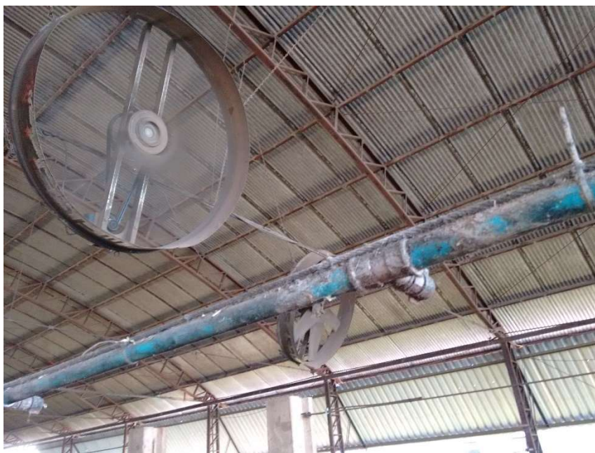
Figura 2 - Foto do sistema de ventilação (ventilador e aspersores de água).
