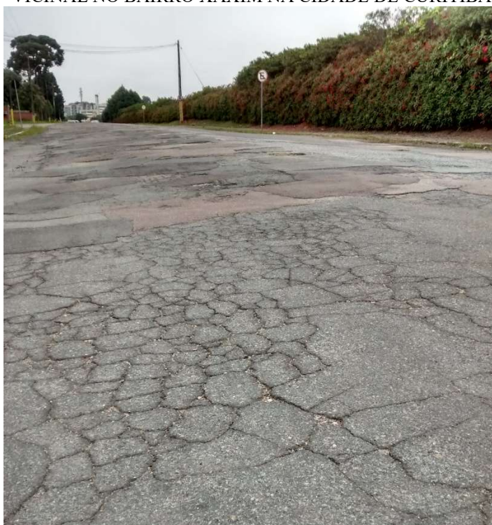
FIGURA 2 - FOTO REFERENTE AO DEFEITO DE TRINCAMENTO POR FADIGA EM UMA RUA VICINAL NO BAIRRO XAXIM NA CIDADE DE CURITIBA
