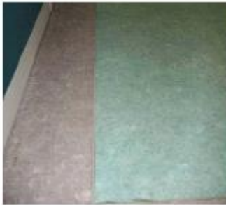
Figura 32: Piso vinílico flexível
