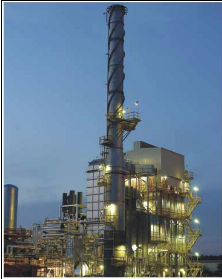
FIGURA 12 – Aspecto de um forno reformador real em uma refinaria. FONTE: Confab Industrial S.A., 2014.
