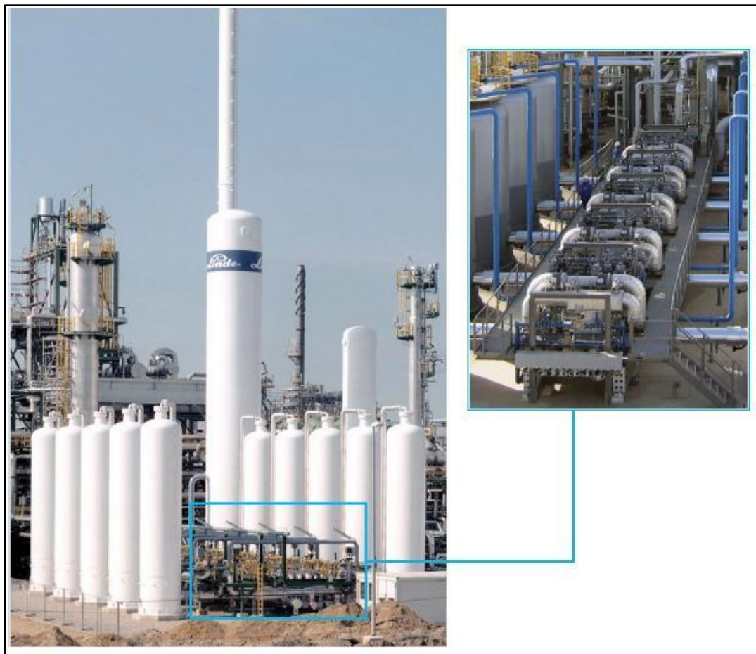
FIGURA 13 – PSA real instalada em um parque de refino e destaque para sistema de válvulas de controle do processo produtivo.
