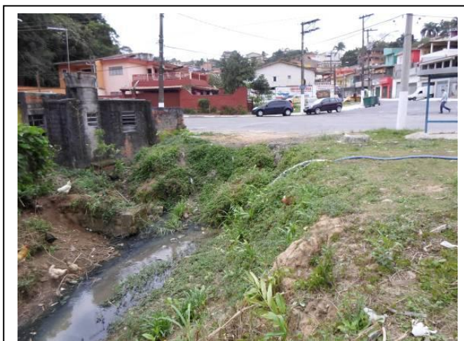
Figura 8: Evidência de remoção de solo e crescimento de gramíneas no talude do sistema de drenagem de esgoto e águas pluviais - São Bernardo do Campo (Fonte: Consórcio DP Barros/Geva).
