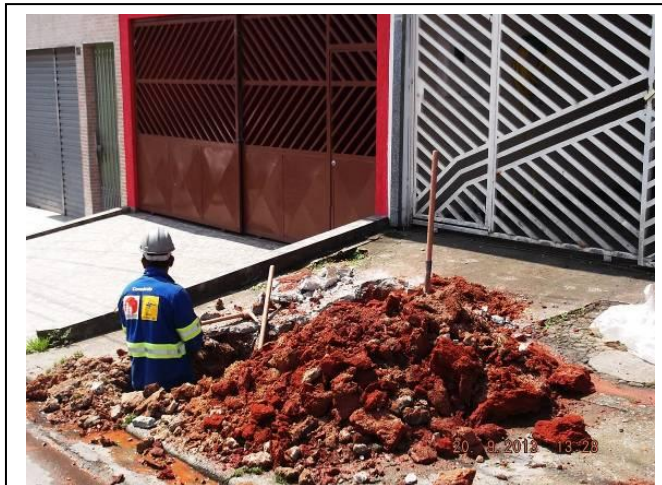
Figura 5: Execução de ligação domiciliar - Jardim Almeida - Parelheiros - São Paulo (Fonte: Consórcio DP Barros/Geva).
